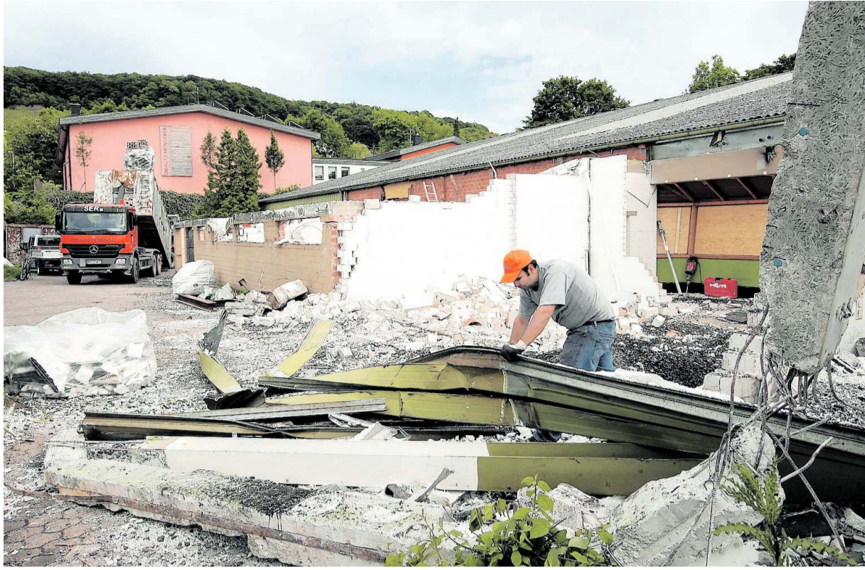
Jetzt geht es Schlag auf Schlag: Nach dem Abriss des Vereinsheims wird umgehend mit dem Neubau begonnen. Mit Beginn der Hallensaison im September soll das in neue Gebäude des TC Heilbronn stehen.
